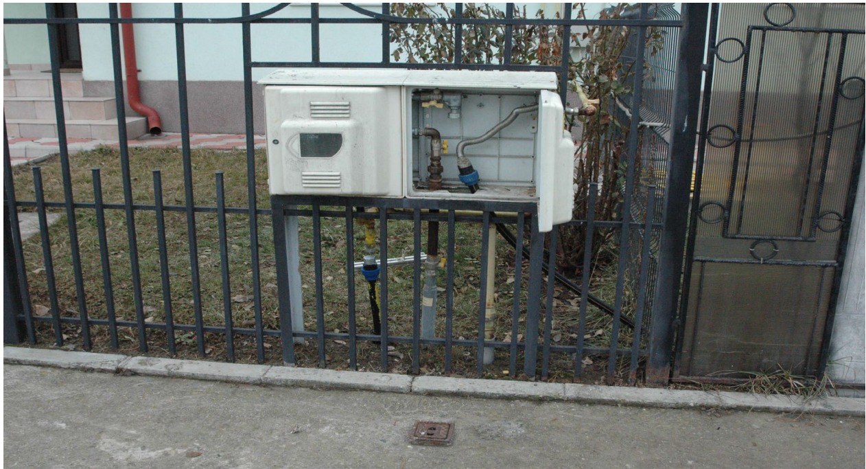
Fig.8 ( racord instalație improvizată)
